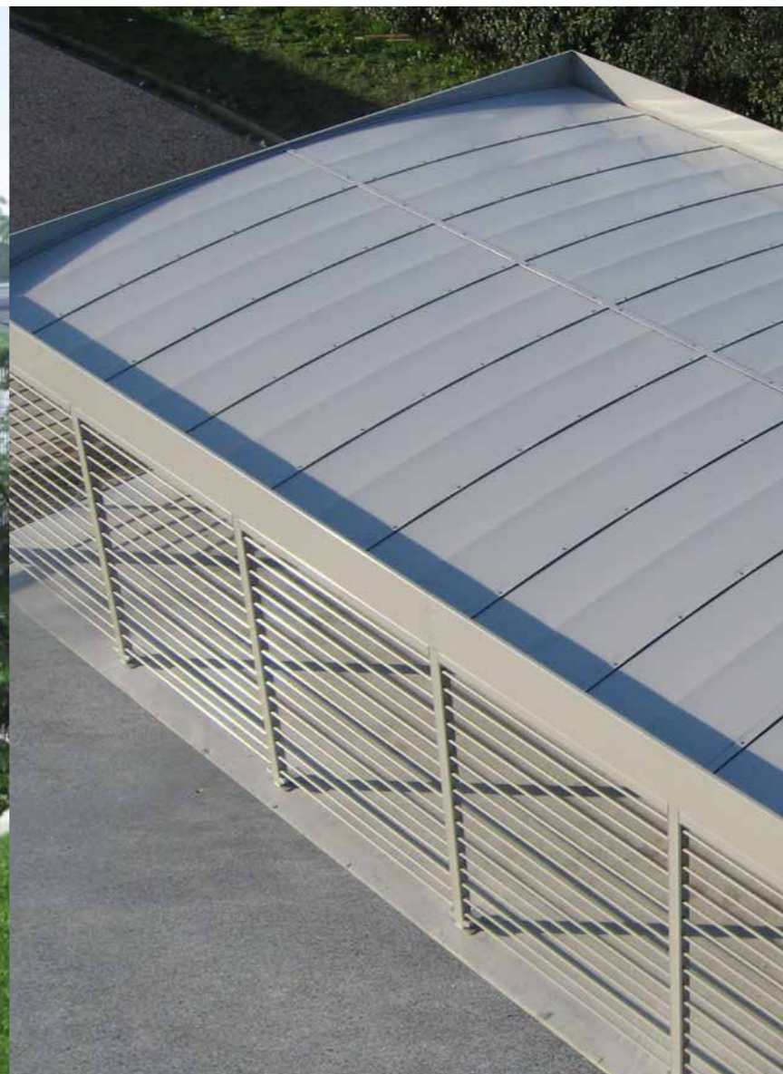
Toulon - La Poste Abri Modul'ère à barreaudage serré
