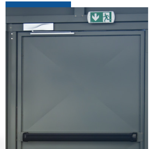
Barre anti-panique mécanique, ferme porte et bloc autonome d'éclairage de sécurité
